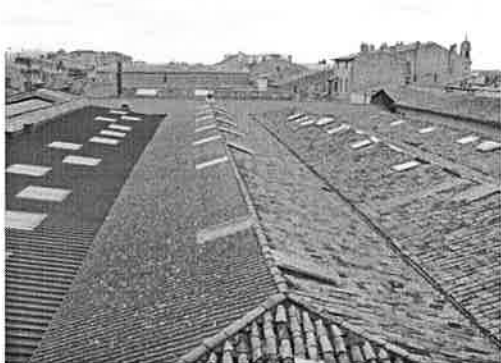
Vue générale des toitures, avec le cours du Médoc sur la droite
