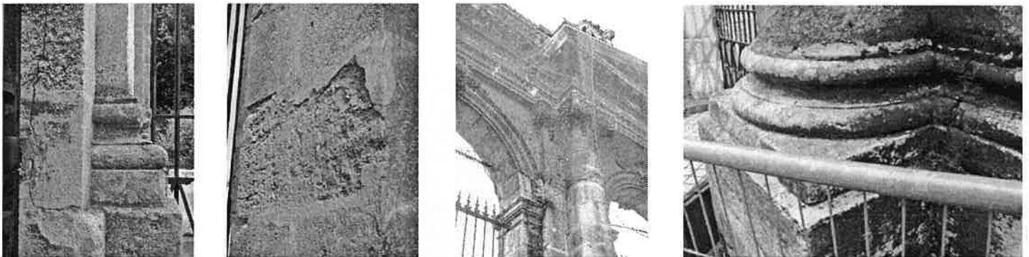
Les dégradations de l'ouvrage avant la restauration, photos : Bruno Phiquepal d'Arusmont et TMH
